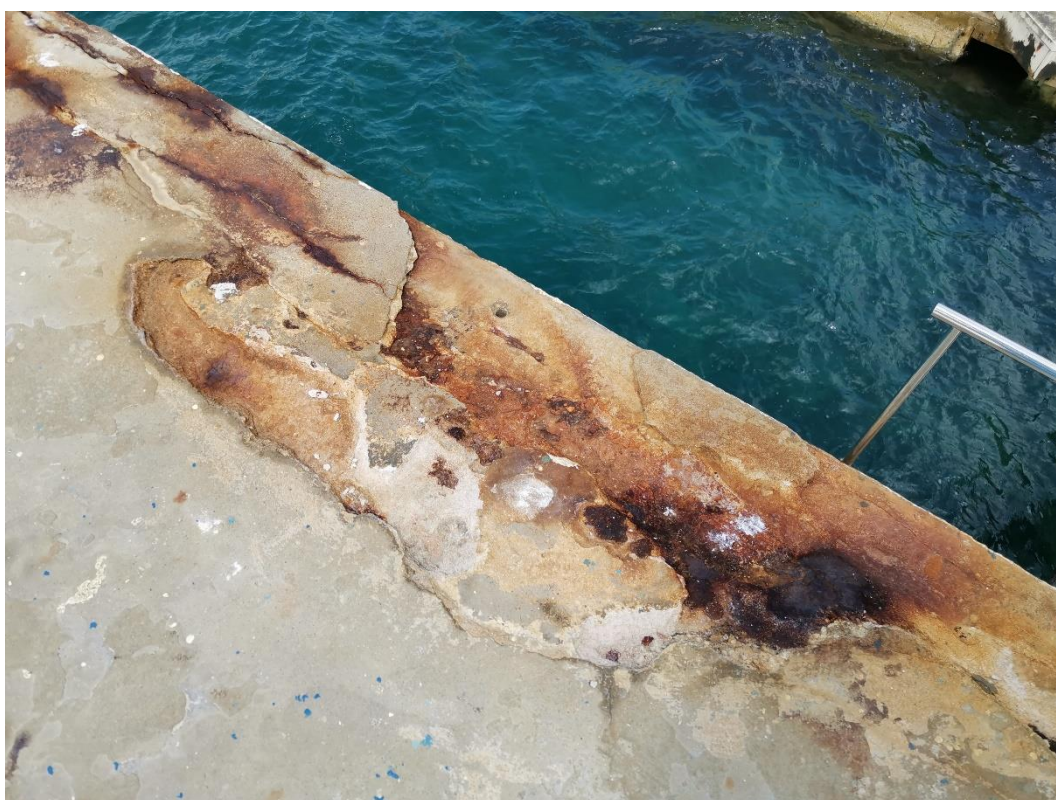
Slika 12. Podest br. 2; mrlje od korozije, odlamanja i ljuštenja betona
