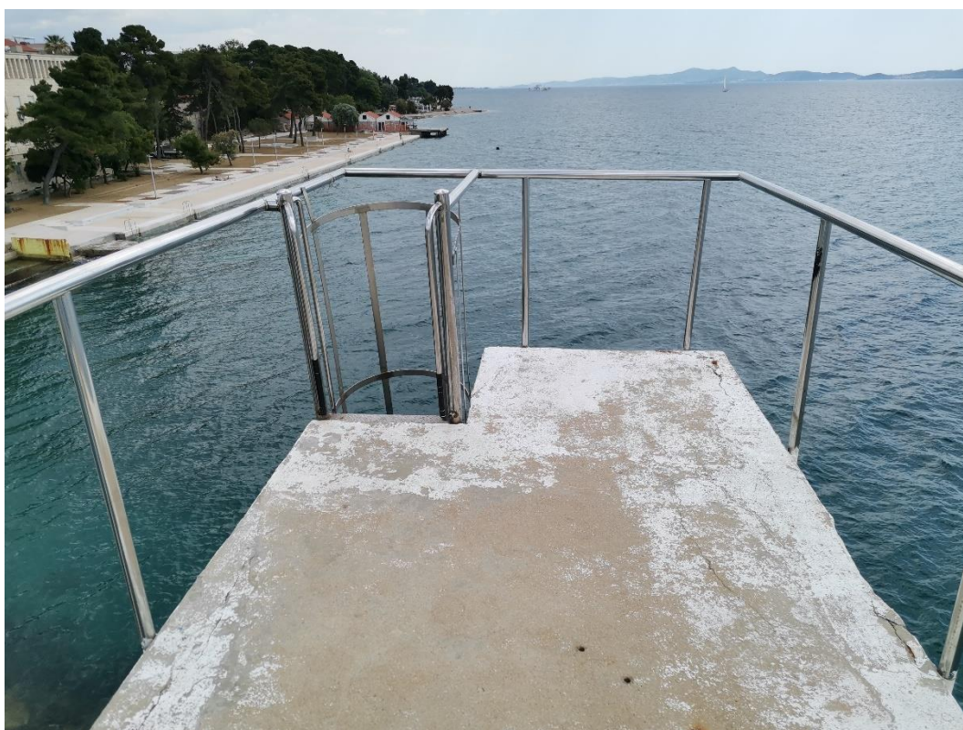
Slika 8. Podest br. 3; odlamanja betona na rubovima ploče, ljuštenje i promjena boje betona
