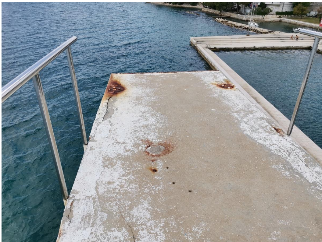
Slika 7. Podest br. 3; mrlje od korozije, odlamanja betona na rubovima ploče i pukotine na površini ploče
