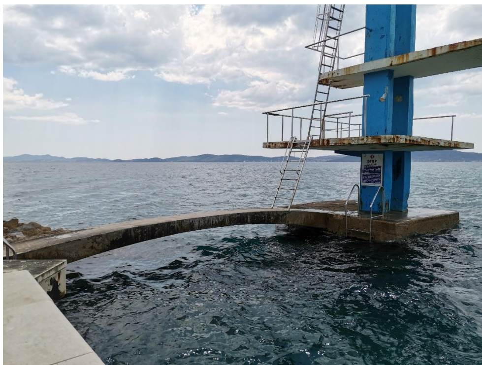
Slika 4. Pogled na AB mostić i donji dio skakaonice; vidljiva ljuštenja betona mostića i mrlje od korozije i odlamanja betona na rubovima ploča podesta
