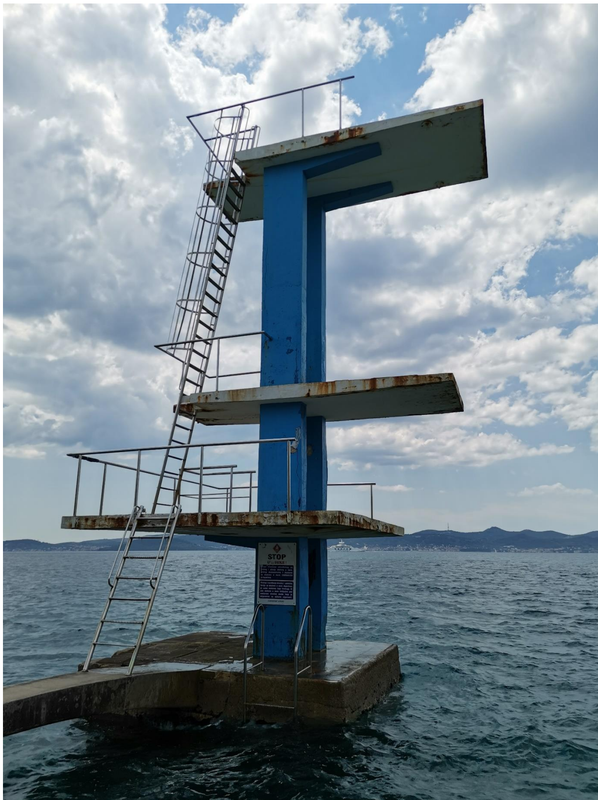
Slika 5. Pogled na skakaonicu; vidljive mrlje od korozije i odlamanja betona na rubovima ploča podesta
