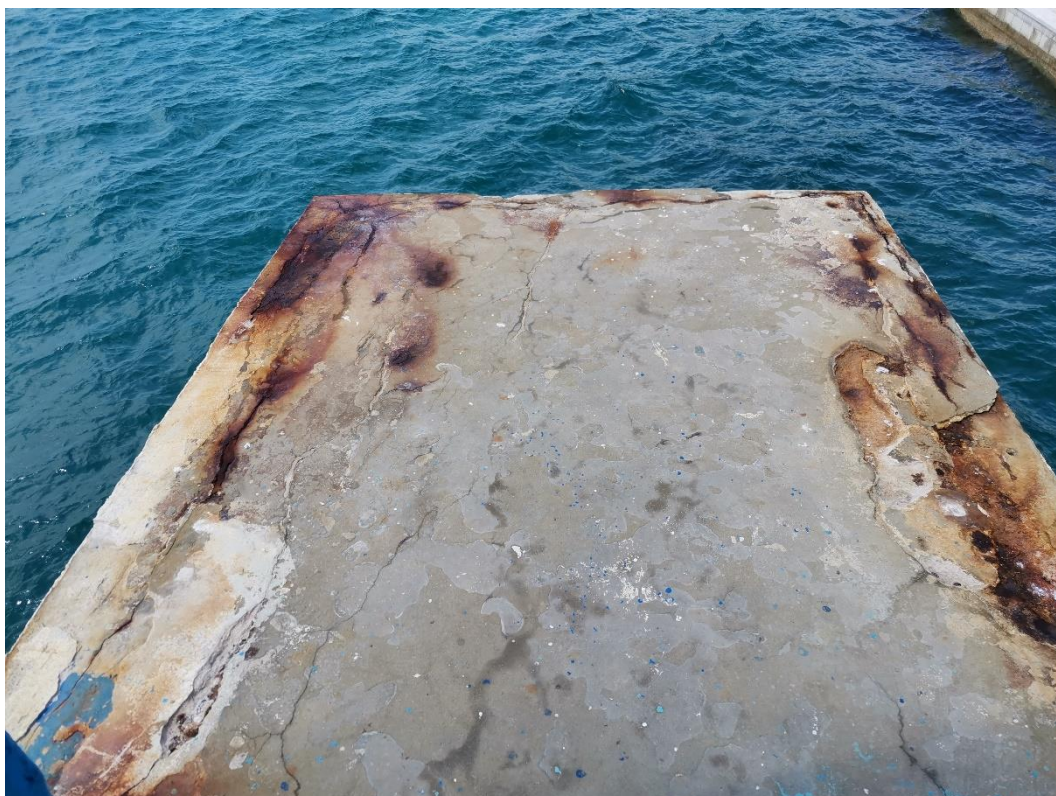
Slika 10. Podest br. 2; mrlje od korozije, odlamanja betona na rubovima ploče, pukotine na površini
